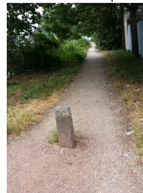
Abbildung 92: Verbindungsweg zwischen Gerhardstr. und Jakobstraße mit Gefahrenpotenzial
